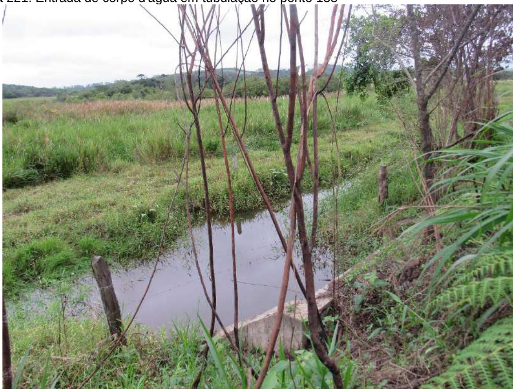
Figura 221: Entrada de corpo d'água em tubulação no ponto 158
