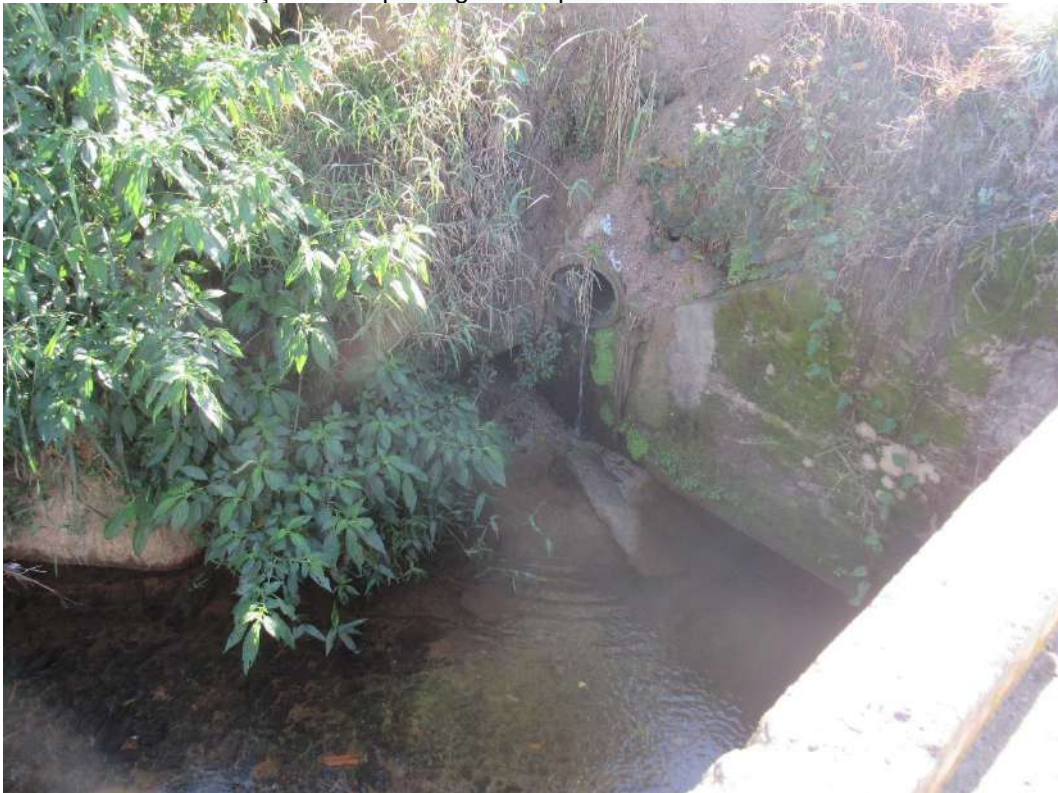
Figura 116: Saída de tubulação do corpo d'água I no ponto 59
