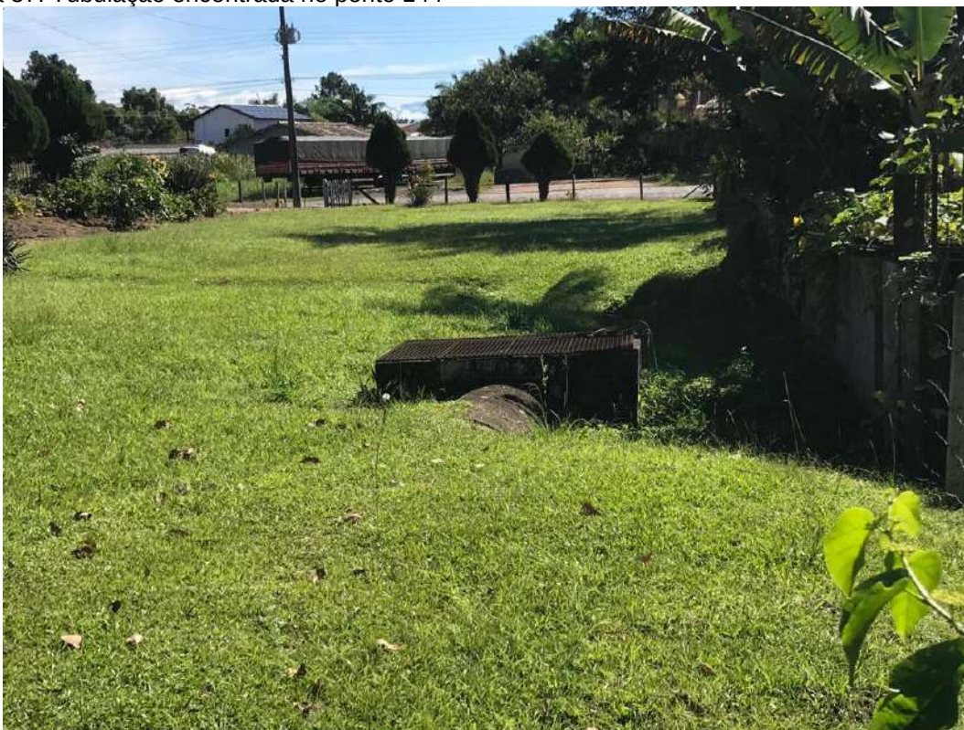
Figura 57: Tubulação encontrada no ponto 144
