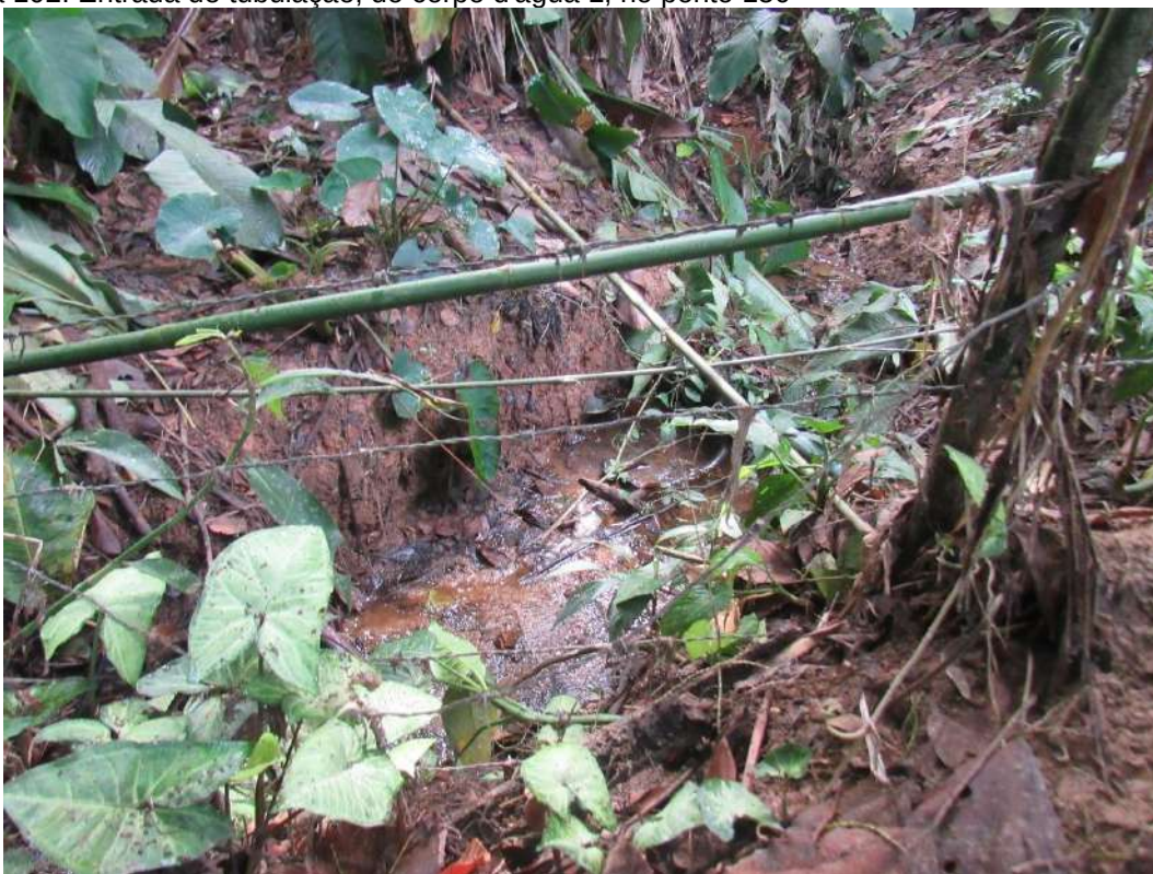
Figura 102: Entrada de tubulação, do corpo d'água L, no ponto 150
