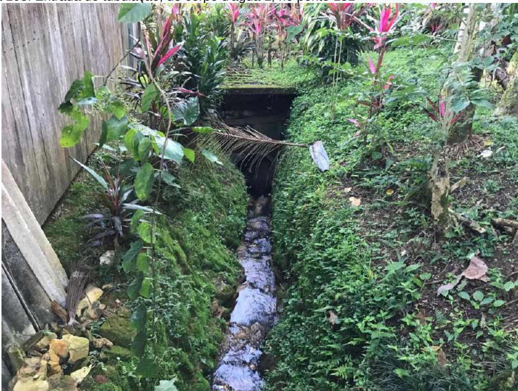
Figura 103: Entrada de tubulação, do corpo d'água L, no ponto 151
