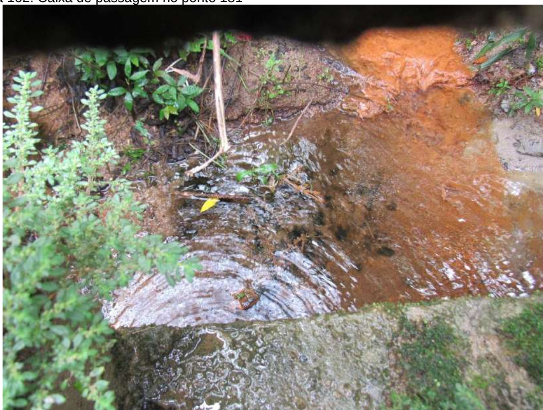
Figura 162: Caixa de passagem no ponto 181
