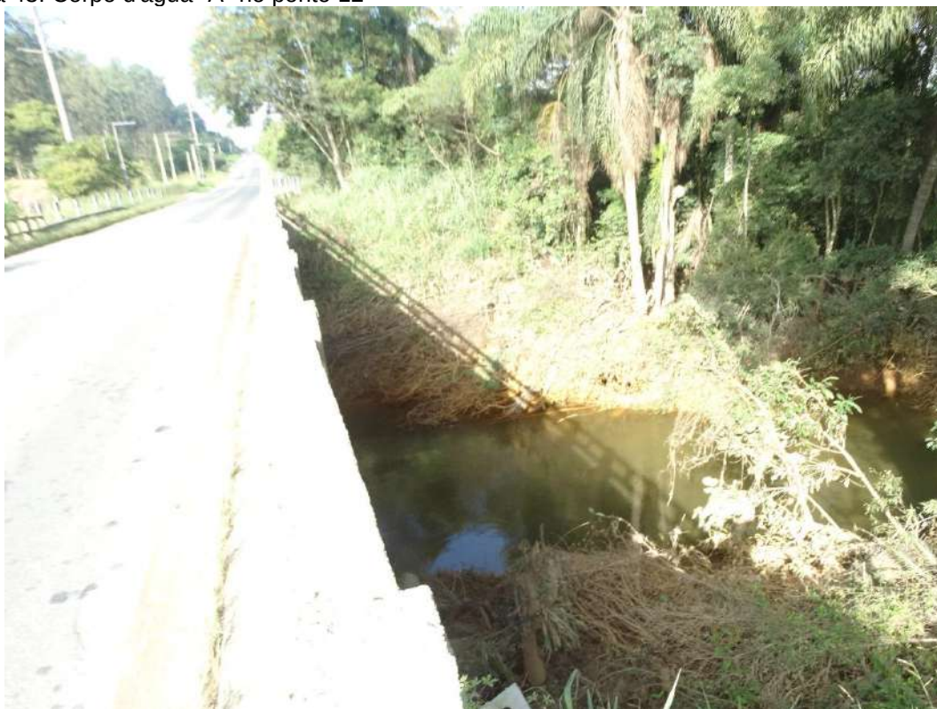
Figura 43: Corpo d'água "A" no ponto 12
