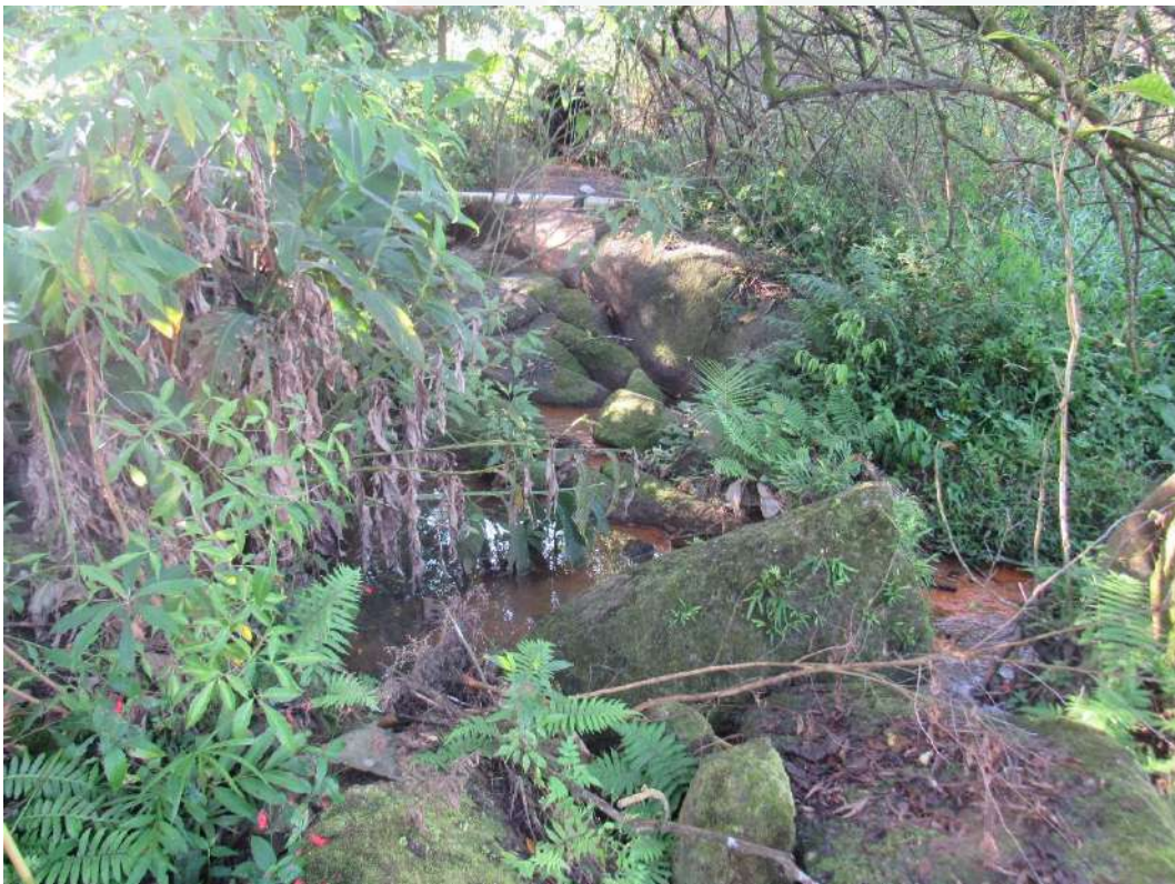
Figura 128: Ao fundo vê-se a saída da tubulação no ponto 190, encontrando com a água do ponto 189
