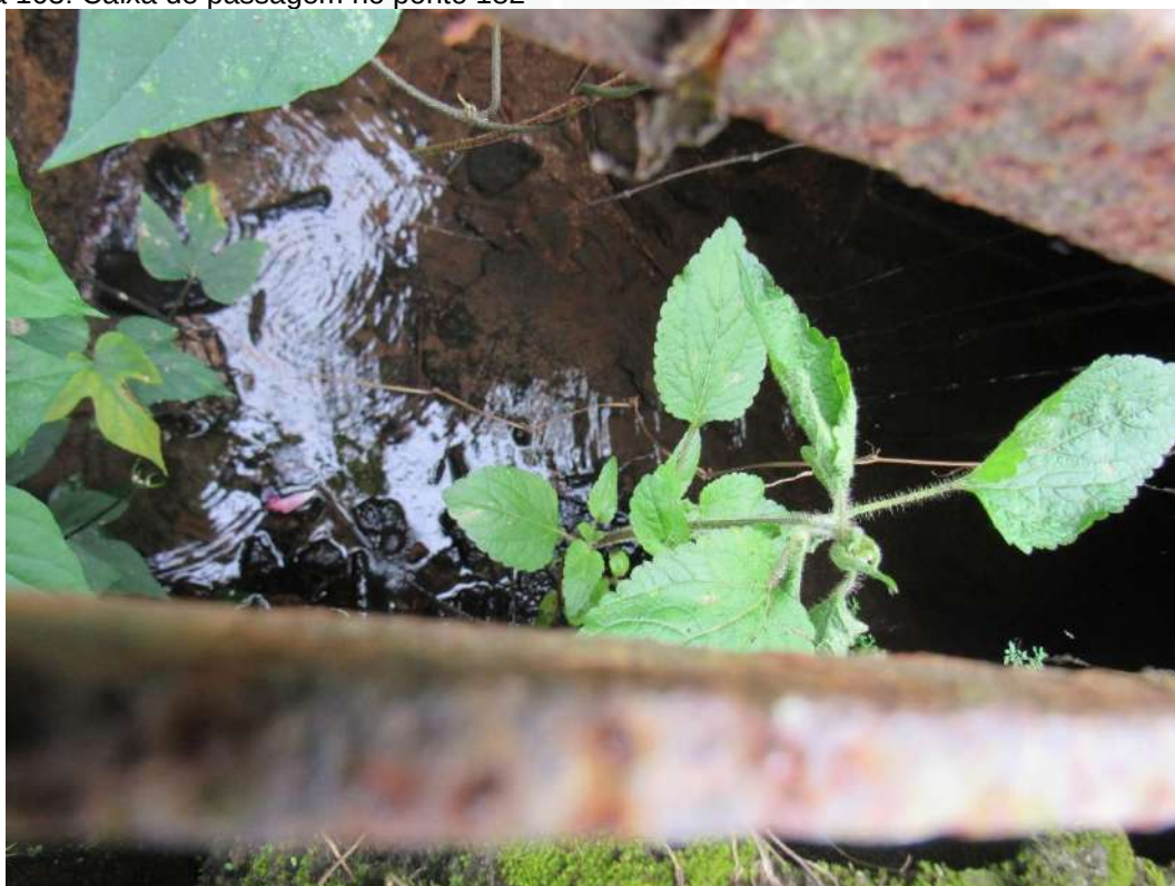
Figura 163: Caixa de passagem no ponto 182
