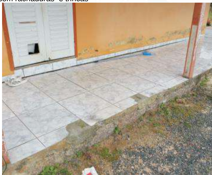
Figura 15: Moradia com rachaduras e trincas
